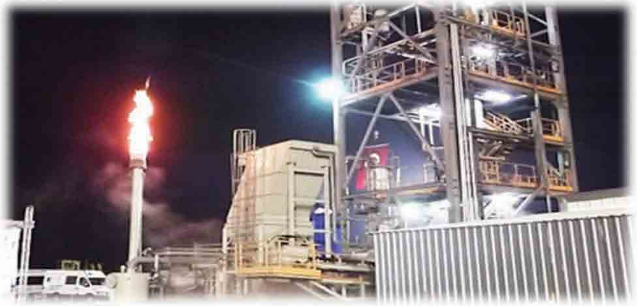
Şekil 55. 250 kg/h Kapasiteli Sürüklemeli Tip Gazlaştırıcı ve Gaz Temizleme Ünitesi
