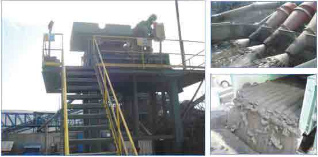
Şekil 48. ELİ Dereköy HG Dryer Kazanım Ünitesi
